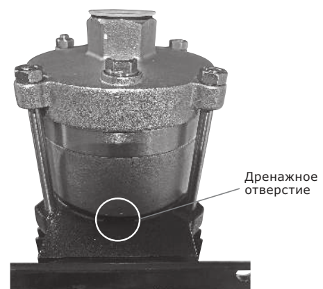
Рис. 11 Дренажное отверстие торцевого уплотнения
