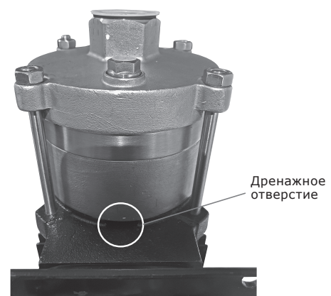
Рис. 11 Дренажное отверстие торцевого уплотнения
