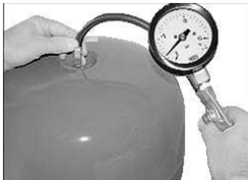
Рис. 6 Контроль давления в мембранном баке
