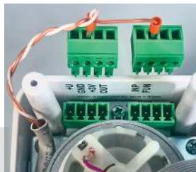
Фото 18. Подключение проводного выключателя к электроприводу
