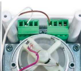
Фото 11. Подключение датчика к электроприводу
