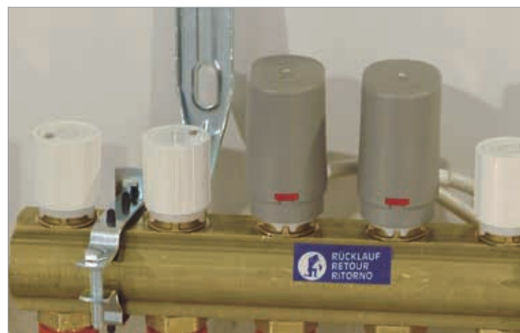
Рисунок 9. Электротермические сервоприводы, установленные на коллектор.
