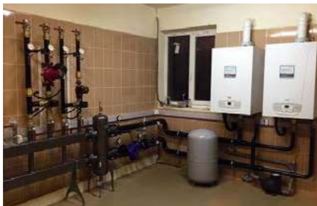
Автосервис, г. Москва Общая мощность котельной - 300 кВт
