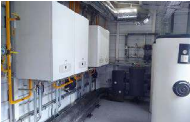
Детский сад, г. Ставрополь Общая мощность котельной - 600 кВт
