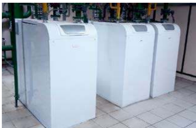
Офисный центр, г. Саратов Общая мощность котельной — 960 кВт
