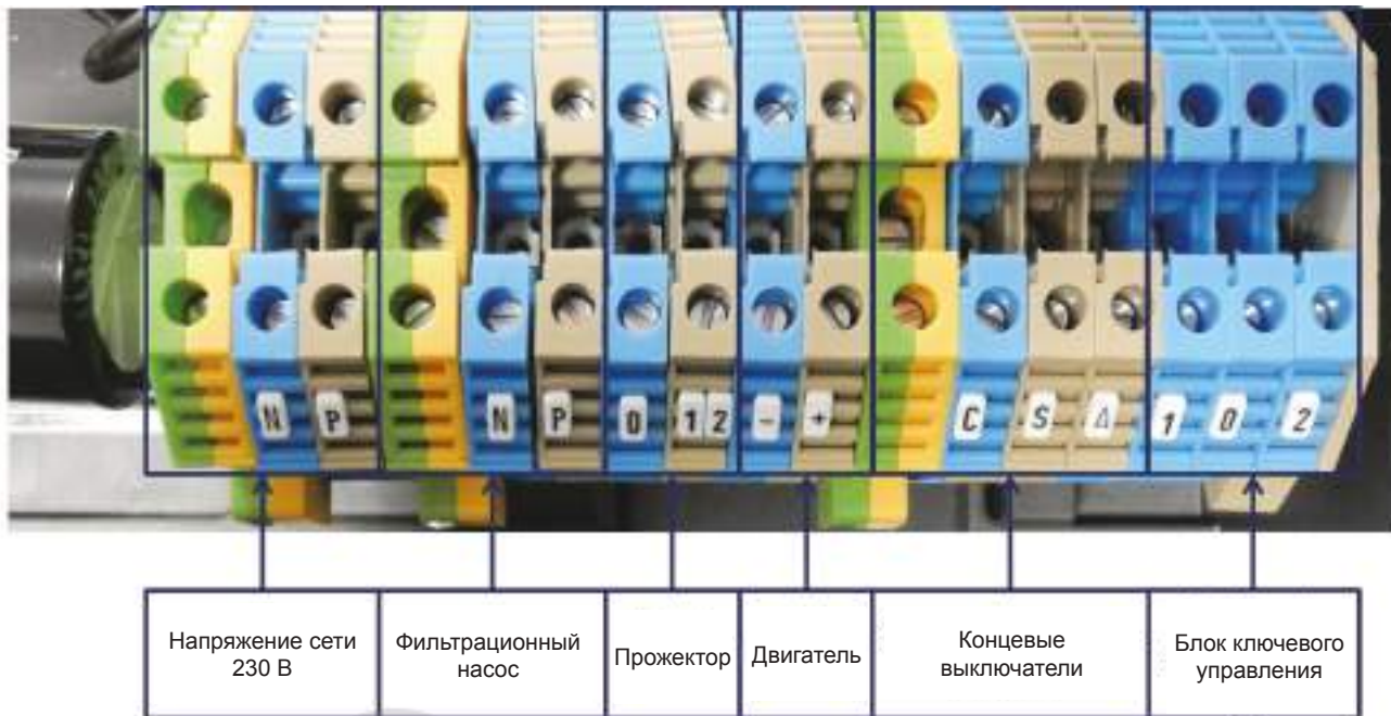
Figure 55 – Электрический щит бассейна PISCINE URBAINE
