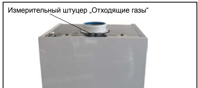
Рис.: Измерение отходящих газов на закрытом котле
