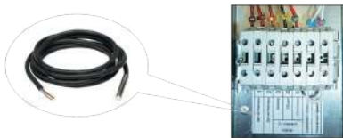
Рис. 21 Подключение датчика температуры бойлера трёхходового клапана к клеммной колодке
